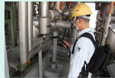
▲設備元件自主檢測
