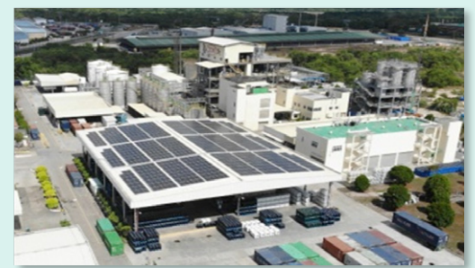
▲大連化工馬來廠太陽能發電裝置
